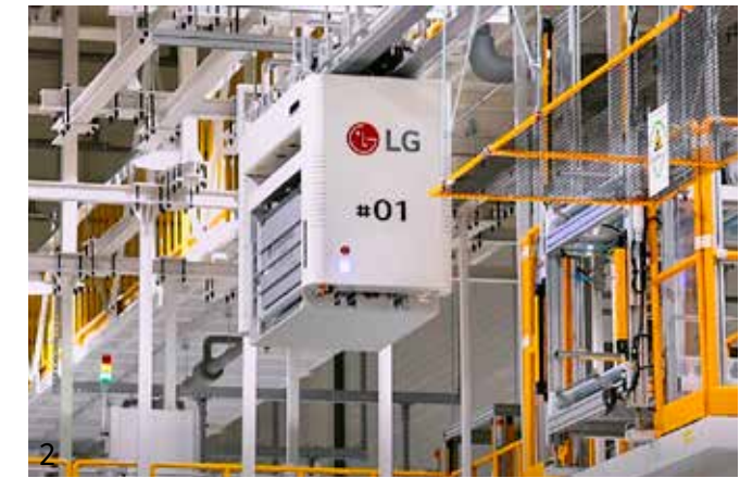
1 지능형 공정 시스템이 보여주는 버추얼 팩토리(Virtual Factory) 2 생산라인 공중에 설치한 고공 컨베이어 3 창원 소재 LG 스마트 파크 전경
